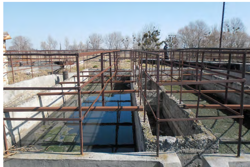
Очисні споруди ДП «Водоканал» м. Ходорів
