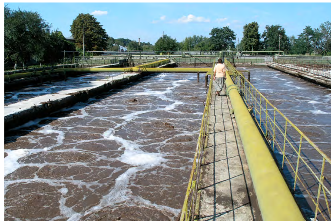
Очисні споруди ЛМКП «Львівводоканал»
